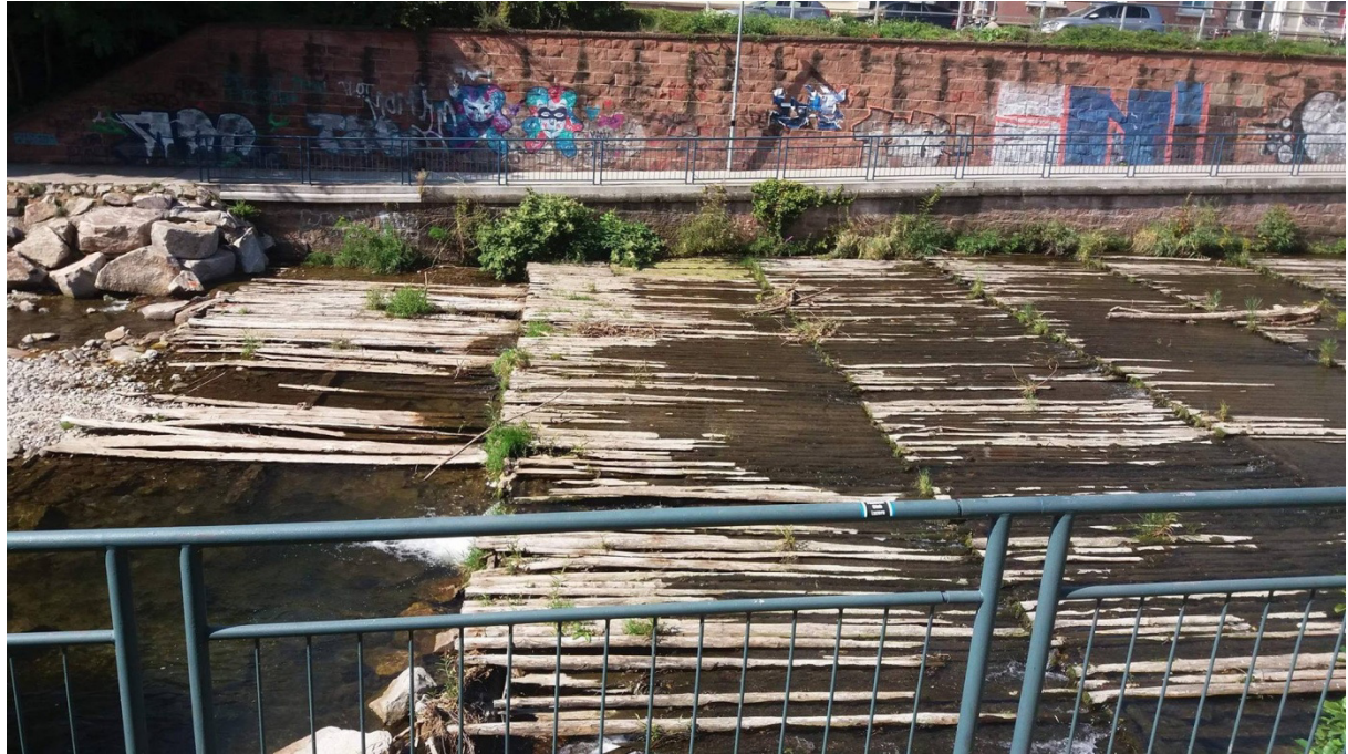
Der Verfall der denkmalgeschützten Baumstammkaskade ist inzwischen noch weiter vorangeschritten. Die Aufnahme datiert vom 28.08.17 und ist vom Südufer mit Blick auf die nördliche Ufermauer aufgenommen (Foto: Lukas Krentzel)
